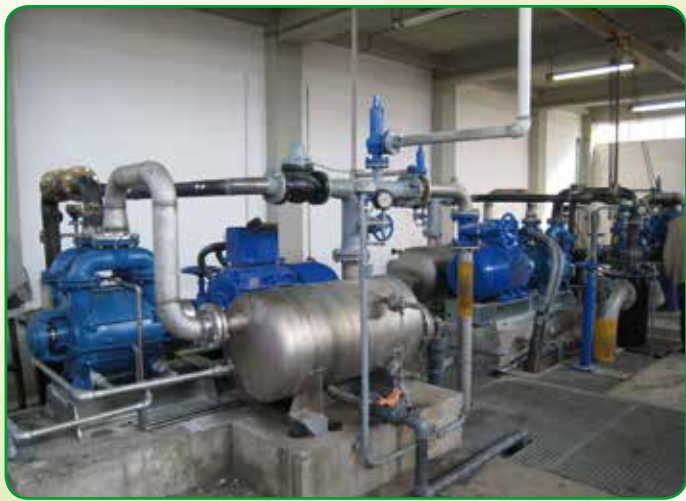
Gruppi Compressori CRVS per la circolazione di Biogas nel digestore.
