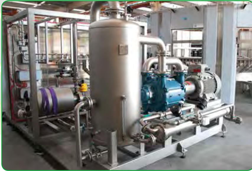
Embotellamiento: bombas de vacío empleadas para aspirar aire en las instalaciones de llenado de botellas de vidrio.
